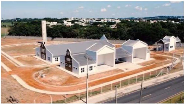
De Holambra Casa Dia do Idoso, em Holambra, encontra-se temporariamente paralisada.
